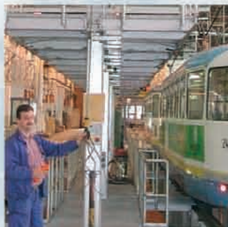
Ausrüstung eines Nahverkehrsbetriebes mit einer KBK-Anlage
